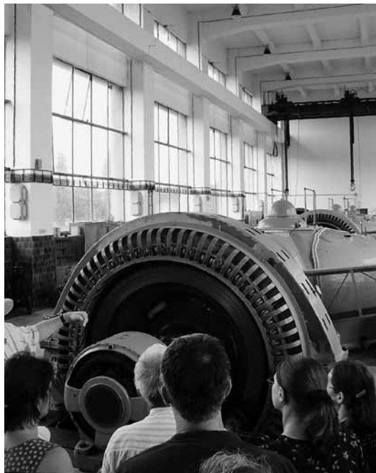
1 Vodní elektrárna v Kostelci nad Labem, exkurze během konference na lodi Malše , červen 2007. / Hydro plant in Kostelec nad Labem, a trip on the boat Malše during the conference in June 2007.
