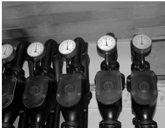
1 Hlavní ovládací panel potrubní pošty se vstupy. / Central control panel of the pneumatic post and input hatches.
