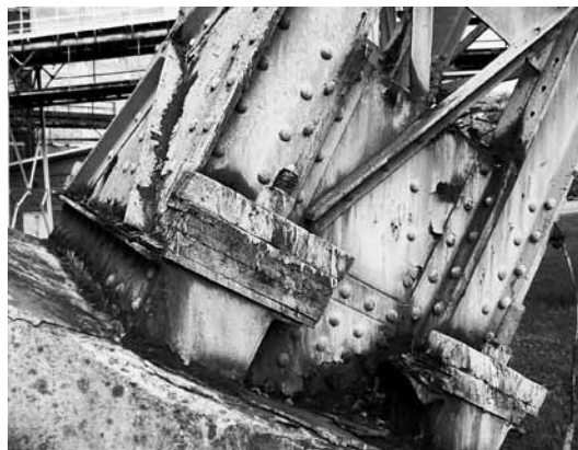
1 Kritické korozní napadení ocelové kotevní vzpěry. / Serious corrosion of steel guy rods. foto / photo Dagmar Knotková (1)
